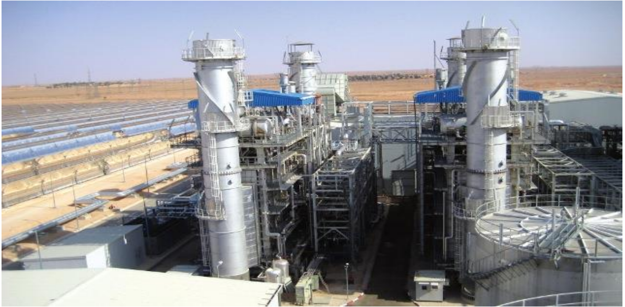
Figure II. 9 : Vue de la centrale hybride (Solar/Gas) de Hassi R'mel [14].
