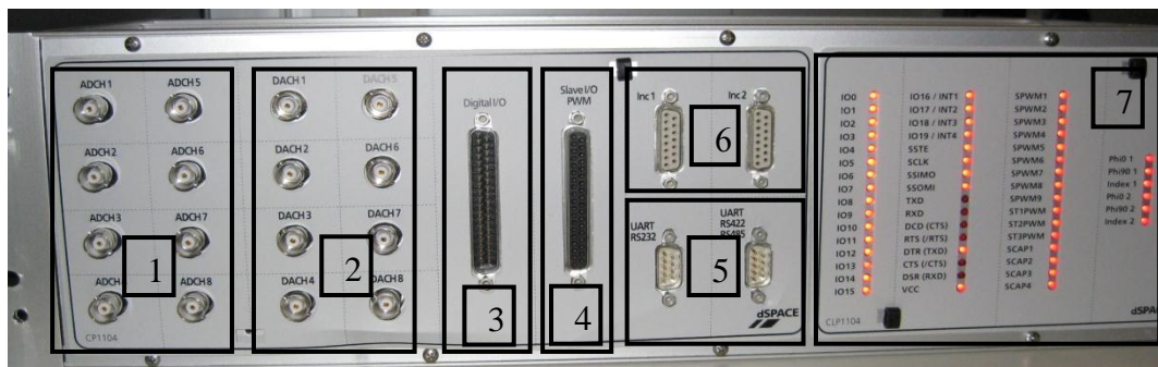
Fig.(VI.3): Panneau de connexion de la DSPACE1104 ( CLP1104 ).
